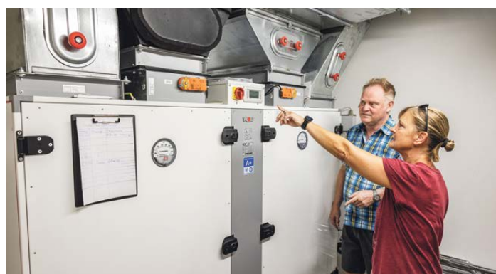
Michael Vorgarten und Brigitte Spiegel vom Kirchenvorstand zeigen die Erdwärmepumpe im Gemeindehaus in Alt-Hausen.
